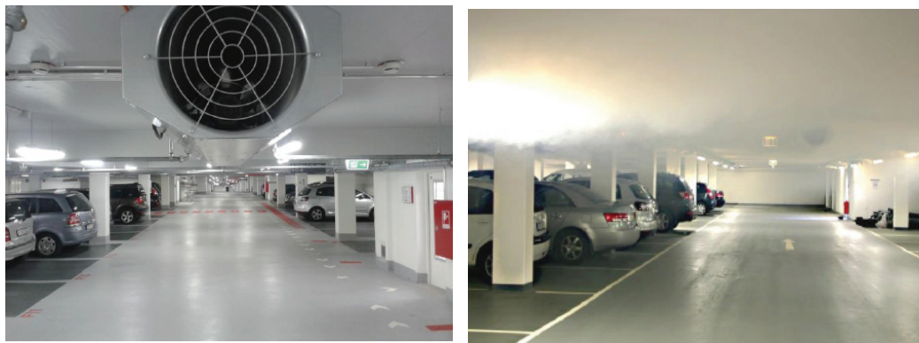
Фиг. 4. Принципна схема на работа на струйни вентилатори за подпомагане отстраняването на отработените газове и димните продукти в закрит гараж
