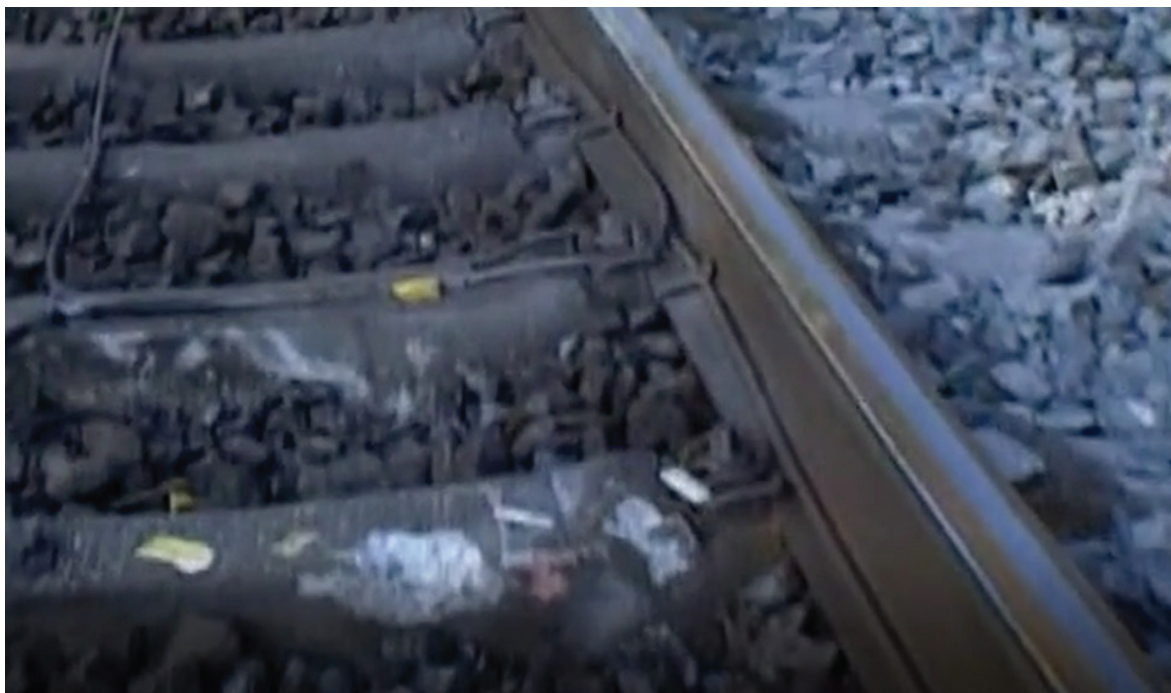
Сн. 7 Повредата на железопътната линия
