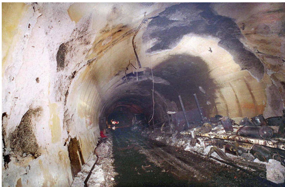
Сн. 2 Щети по тунела и автомобилите след пожара
