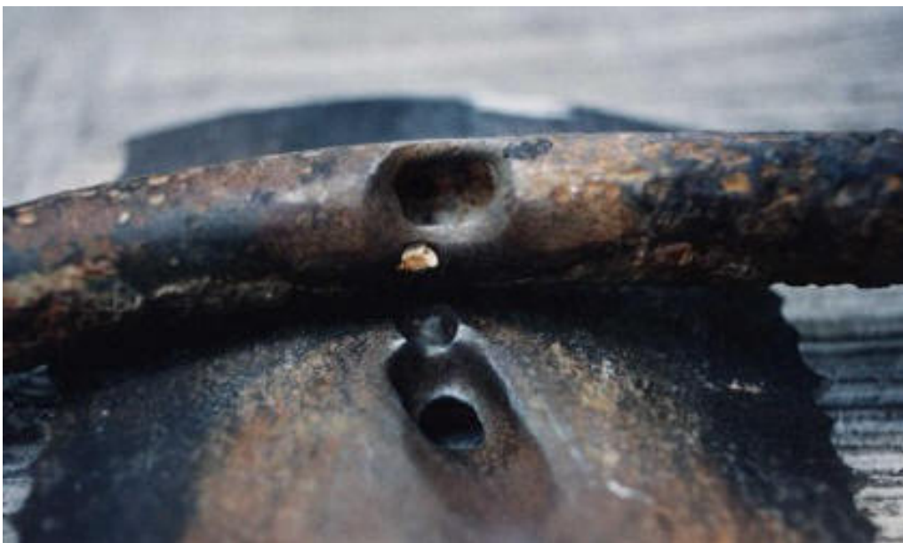
Сн. 4, 5 и 6 Водопроводната тръба, преминаваща около газопровода и получения пробив в тръбата
