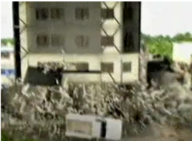
Сн. 1 Моментът на експлозията, заснет от камера на съседна сграда
