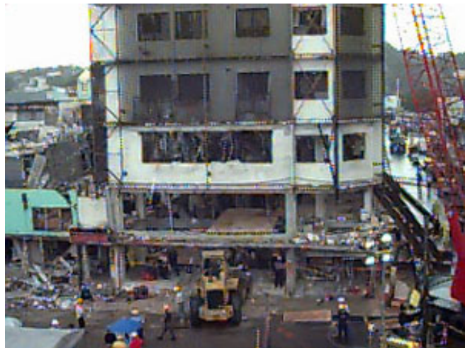
Сн. 2 Щетите върху сградата след експлозията
