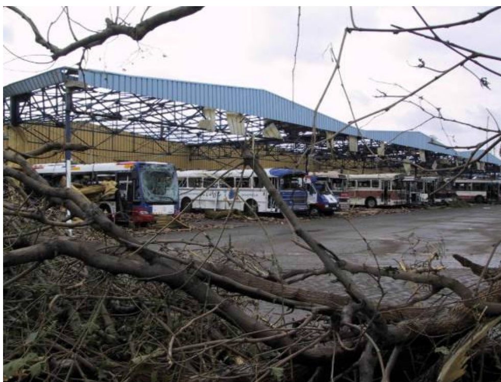
Сн. 7 Разрушеното депо за автобуси
