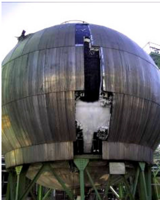
Сн. 4 Щети нанесени върху повърхността на резервоар с амоняк
